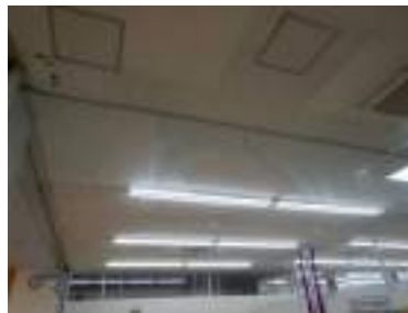
天井やバラスモークの破損 (長岡市中之島)
