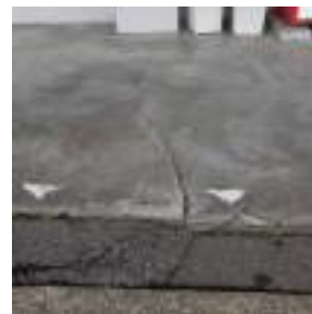
コンクリートの損傷 (長岡市中之島)
