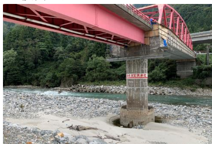
図1 黒部川扇頂付近の橋脚周辺河床洗掘現況
