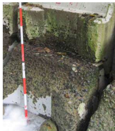
（図 1）山形県の酢川における護床ブロックの腐食状況（片山・沖中（2010）より引用）
