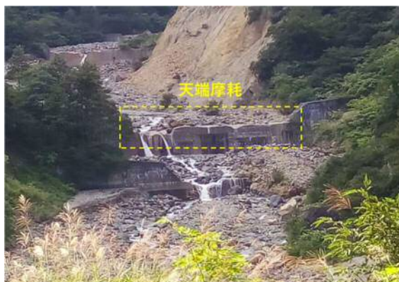
(図1) 浦川流域で確認された天端摩耗
