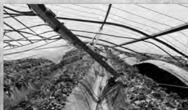
栃木県小山市で発生した イチゴ用ハウスの被害
