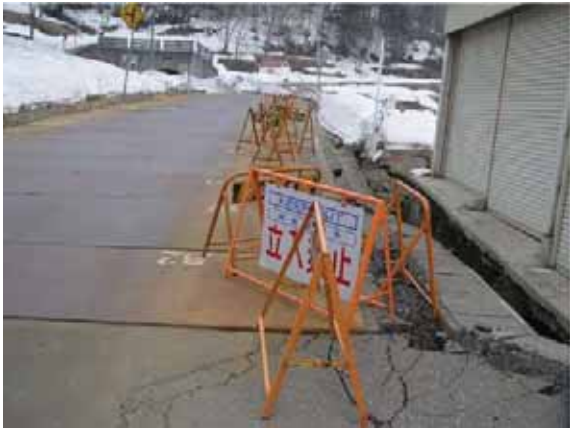
写真7-2 長野県栄村北信横倉地区国道脇の変状1
