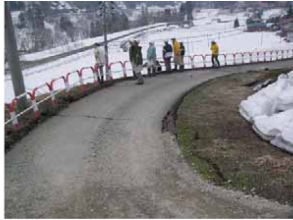
写真7-3 長野県栄村北信横倉地区国道脇の変状2
