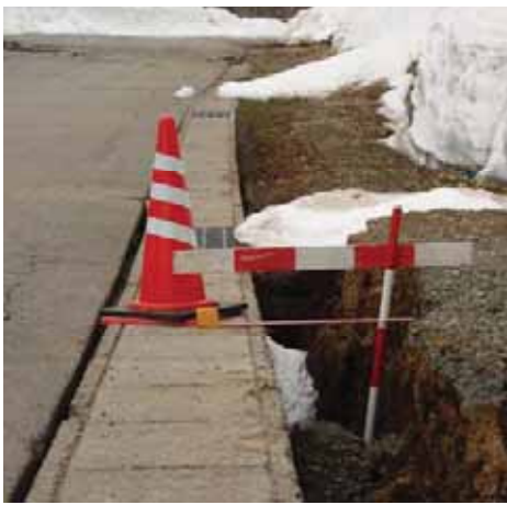
写真6-3 長野県栄村北信青倉の変状箇所 (地すべり：開口部の例)
