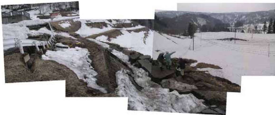
写真7-4 長野県栄村北信横倉地区法面の崩壊
