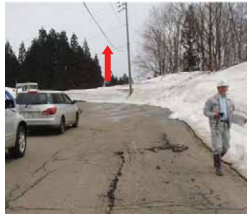
写真6-4 長野県栄村北信青倉の変状箇所 (地すべり：架線のゆるみ)
