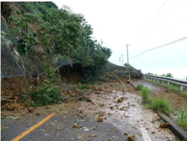
写真－３ 国道３５２号線の崩壊土砂（柏崎市椎谷・観音崎）
