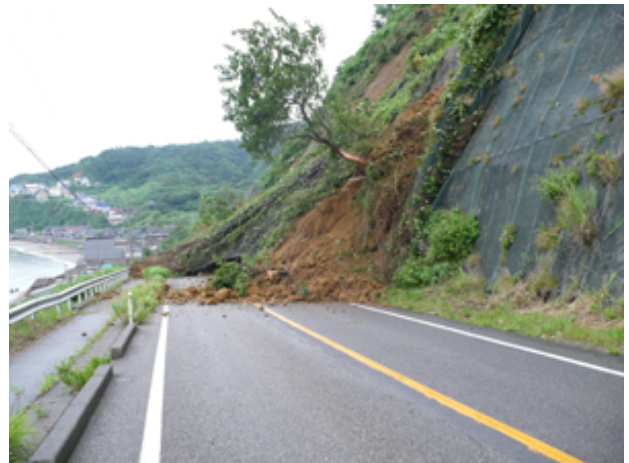
写真－２ 国道３５２号線の崩壊土砂（柏崎市椎谷・観音崎）
