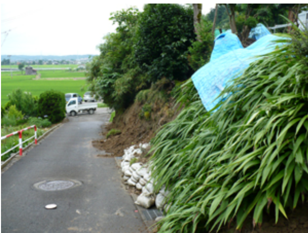
写真－９ 宅地造成盛土斜面の孕み出し（刈羽村赤田北方地内）
