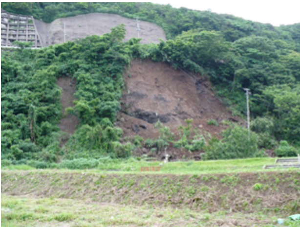
写真－１３ 急崖の表層崩壊（柏崎市青海川地内）
