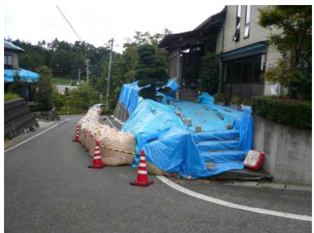
写真 10 ⑤地点のコンクリート擁壁の損壊.
