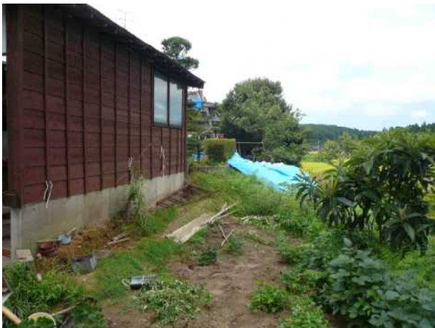
写真1 ①地点における斜面上部の亀裂。
