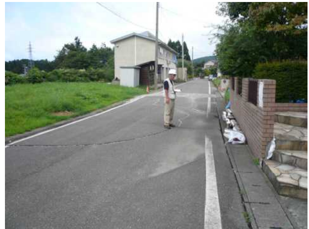
写真 8 ④地点における円弧状の開口亀裂.
