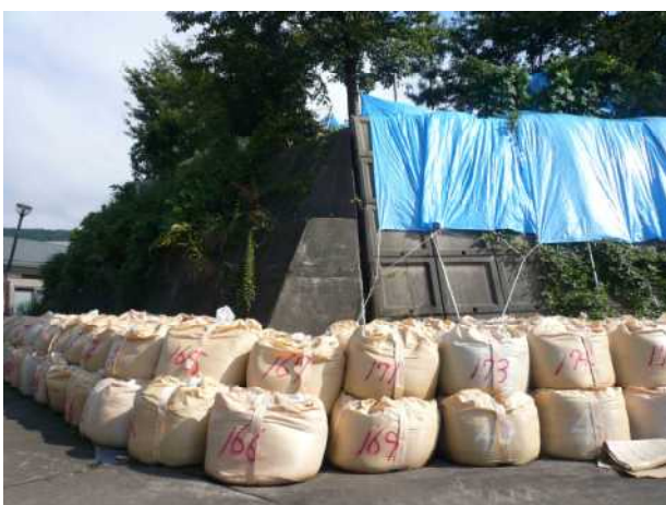
写真 9 ④地点の斜面末端部におけるコンクリート擁壁の押し出しと損壊.
