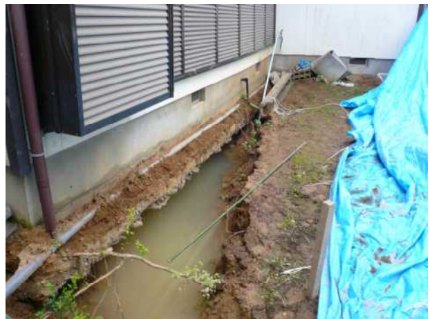
写真4 ②地点における開口亀裂。
