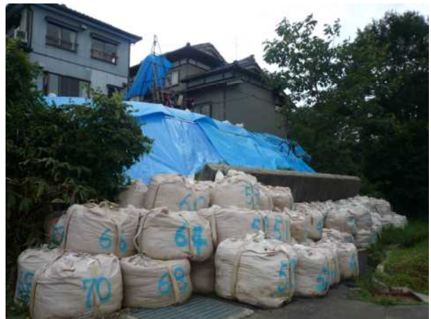
写真2 ①地点におけるコンクリート擁壁の損壊。
