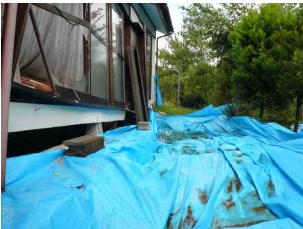
写真3 ②地点における開口亀裂と大破した住家。
