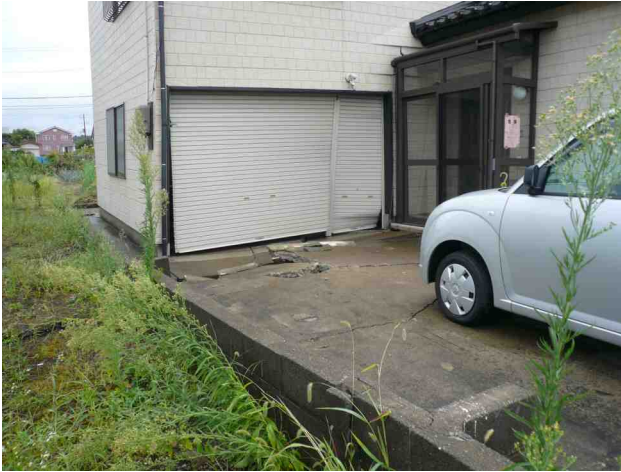
写真 1 流路に相当する地盤の沈下によって大きな被害を受けた住家。写真左側が開口亀裂を伴い沈下した。亀裂は建物を横断している。
