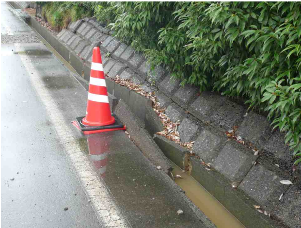
写真 2 旧流路部分に相当する箇所での道路の変状。旧流路部分が沈下したため中央で圧縮変形が起きている。
