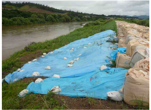
写真 3 鯖石川左岸の堤防の沈下
