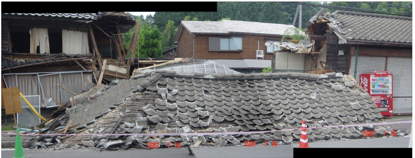
↑ ⑨刈羽村十日市 全壊した古い木造の建物。全壊した建物とつながっていた右側の建物は比較的新しく、全壊を免れている。
