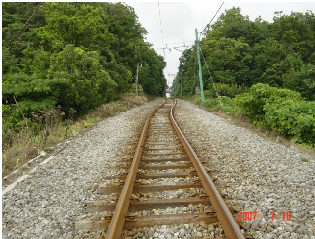
↑ ⑦山本付近の越後線 線路が歪んでいる。枕木も線路と共にずれている。
