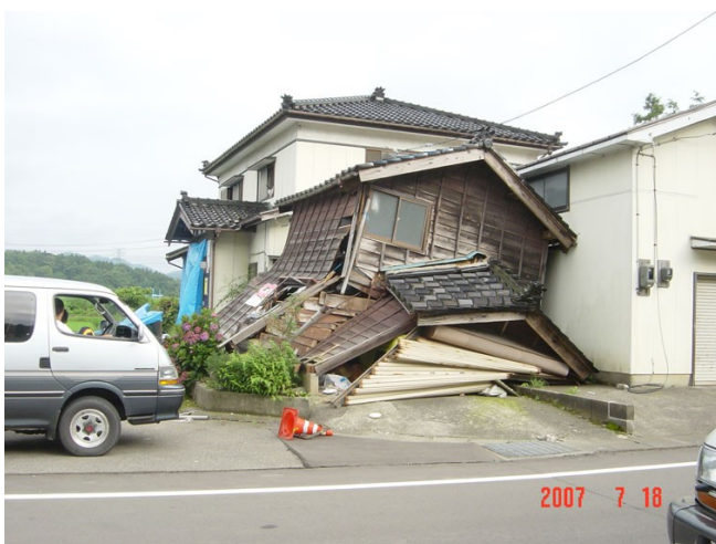
↑ ⑩⑨同所 一階部分が倒壊した木造の建物。一階ガレージ内の自動車が閉じ込められている。
