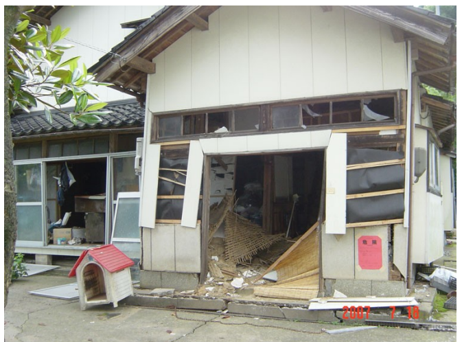
↑ ⑪⑨同所 全壊した木造の建物。右端に『危険』と書かれた赤い紙が貼られている。
