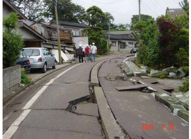
↑②①同所 旧河道側のブロック塀の倒壊。奥の建物は手前側に傾斜している。
