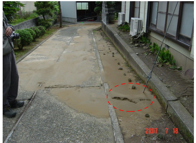
↑④①同所 旧河道側の液状化による噴砂。右側手前 にある噴砂孔は約20cmの幅がある。
