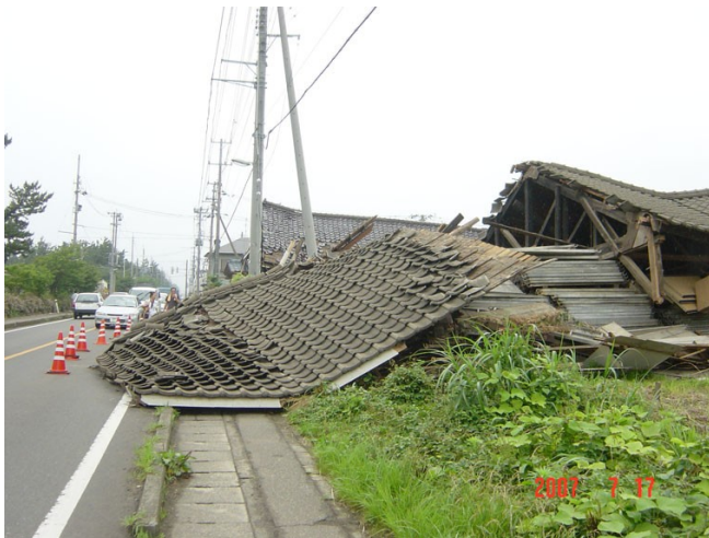
↑ ⑦松波 全壊した古い倉庫。道路側に倒壊して、自動車の通行を困難にしている。
