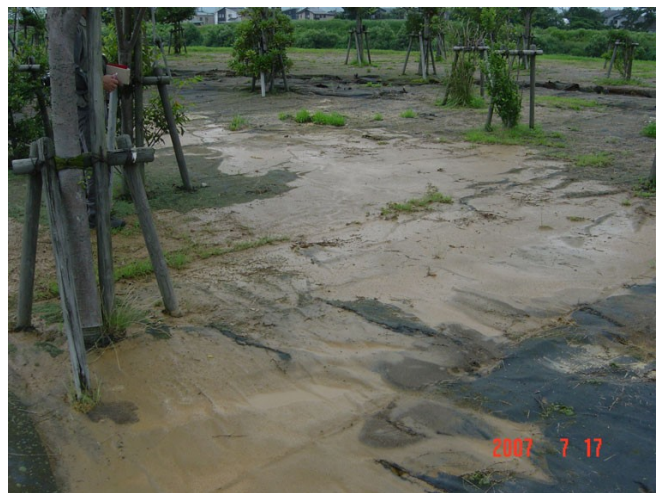
↑ ⑫⑪付近 液状化による噴泥。亀裂部分から発生した。
