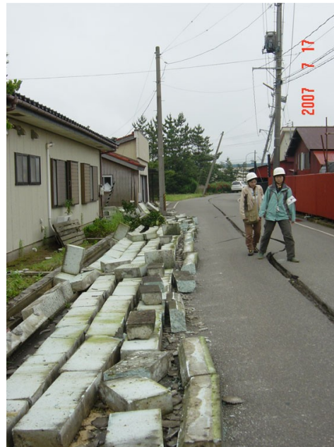
← ⑧松波 ブロック塀の倒壊と道路の亀裂。ブロックがバラバラに倒壊している。道路は中央から裂けている。
