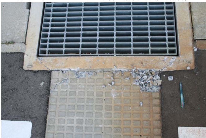
コンクリート製側溝の断裂（与板町）
