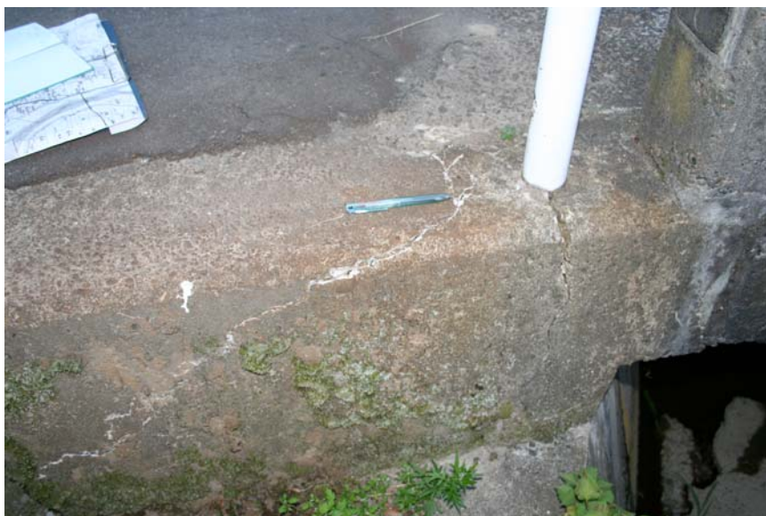
コンクリート製の橋の基礎の断裂（与板町）
