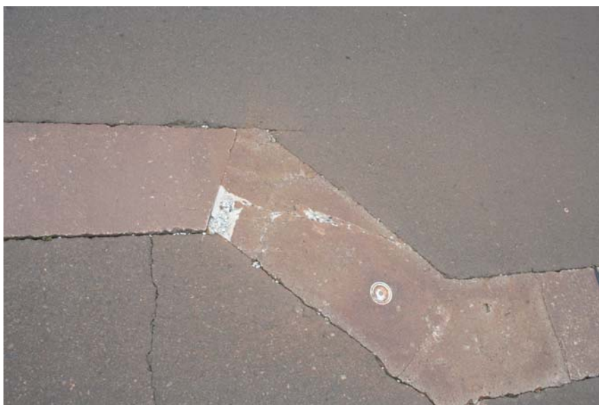
消雪パイプのコンクリート部の断裂（与板町南部）
