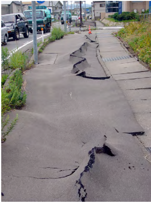
柏崎市安政町南部の国道沿いの歩道に見られる 不同沈下と短縮性の変状。歩道の地盤が短縮した ためにアスファルト舗装が折り曲げられています。
