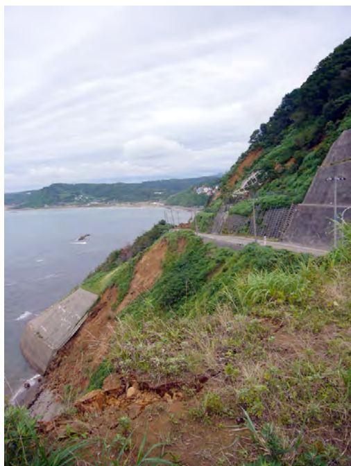
観音岬突端から見た崩壊斜面
