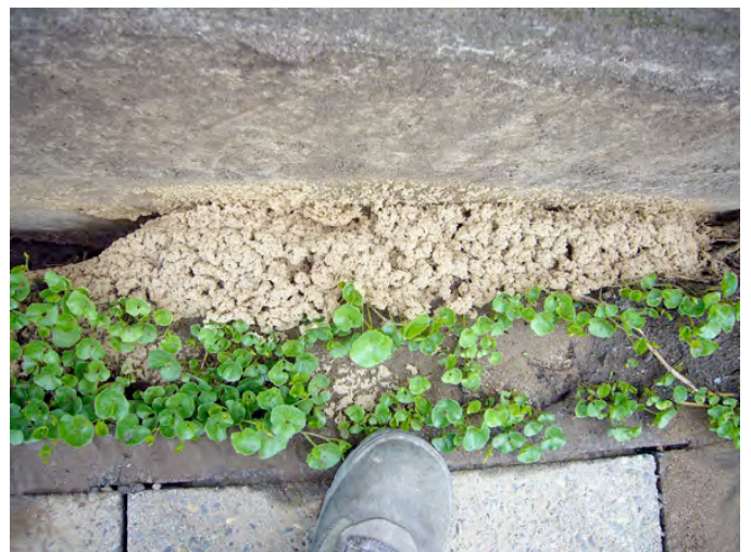
柏崎市大崎の長磯海岸付近の堤防と道路の間に見られる液状化・噴砂の跡に見られる細粒物
