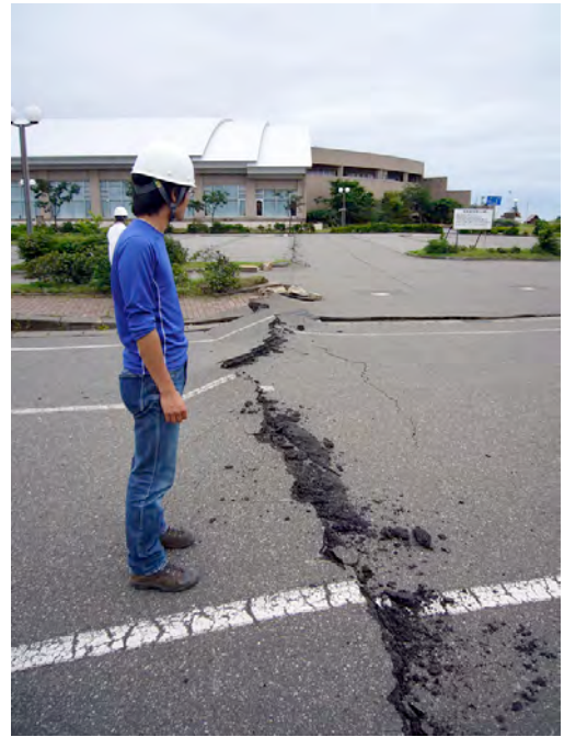
柏崎アクアパーク付近の道路に見られる 短縮性変状。北東-南西方向に延びて、奥 の駐車場内の変状へと続いています。
