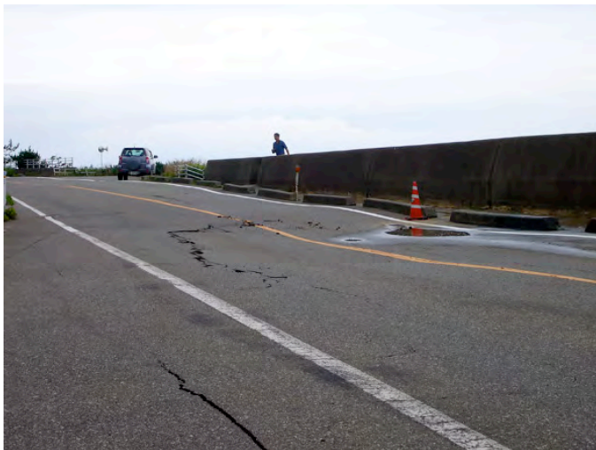
柏崎市大崎の長磯海岸付近の国道352号線に見られる亀裂と沈降
