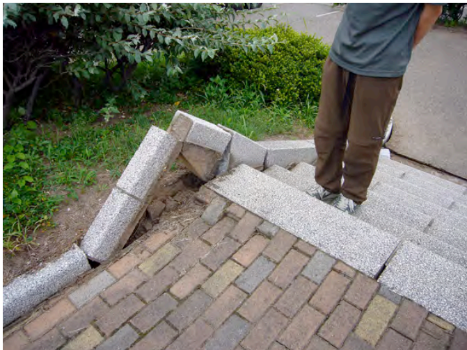
柏崎アクアパーク内に見られる歩道の短縮性変状。 北東-南西方向に延び、北西-南東方向の地震動に よって形成された可能性があります。
