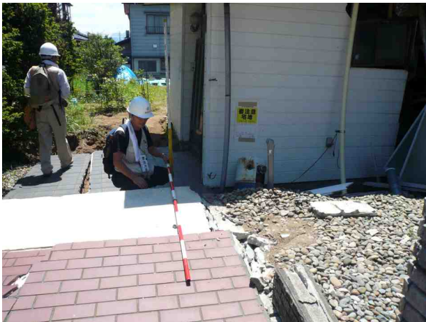
写真 5 B地点における地すべりの開口亀裂と凹地状（溝状）の変形.
