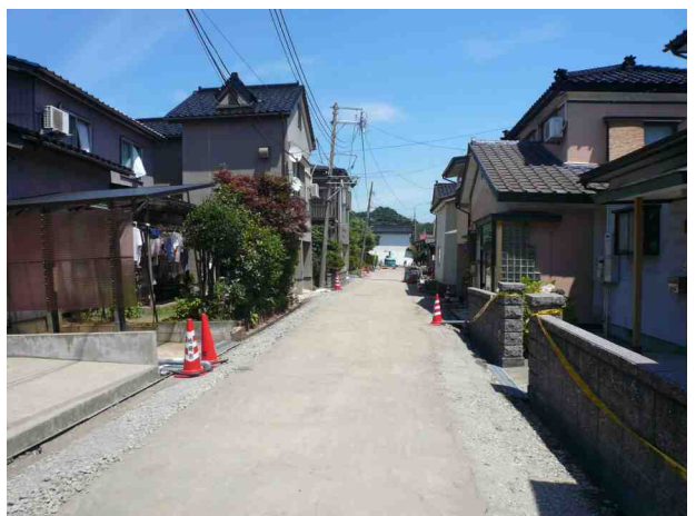
写真 8 C地点における住家の液状化による不等沈下.
