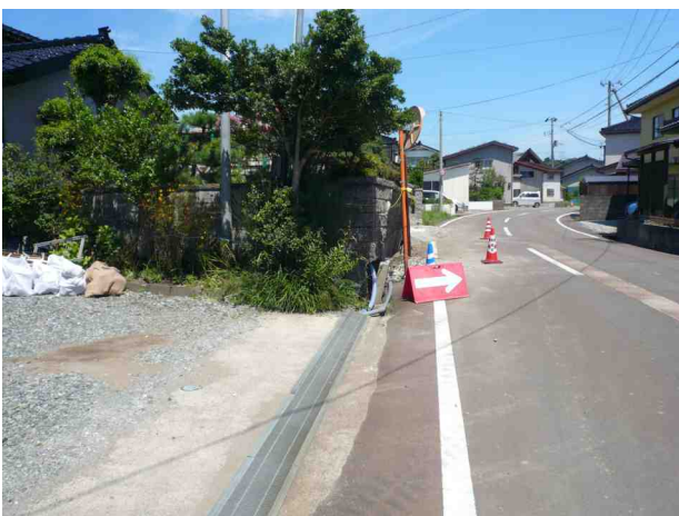
写真 7 B地点における地すべり末端部の圧縮と道路側溝の変状.
