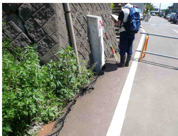
写真2 A地点における宅地全体の押出しによる圧縮変形．側溝部分が短縮してなくなっている．
