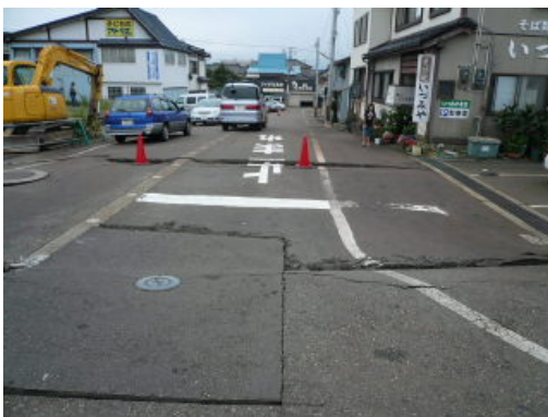
左写真：道路の亀裂（西本町 2）
