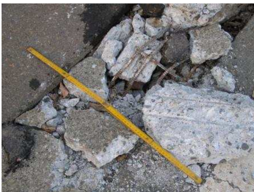
小千谷市西吉谷の消雪 パイプ（国道 403）
