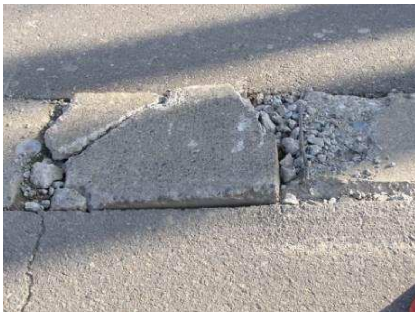
長岡市村松町では消雪 パイプ（県道 472）
