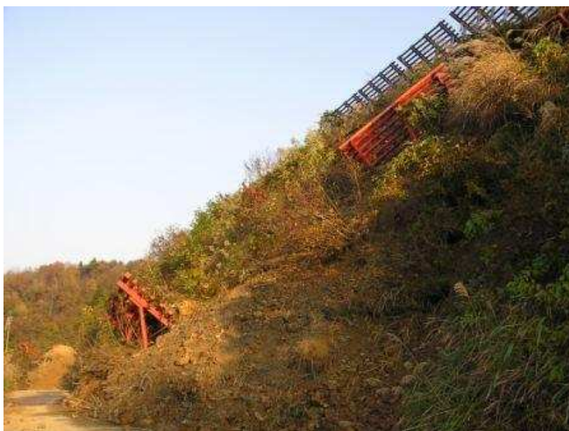
小千谷市桜町の雪崩予 防柵（旧国道 291）
