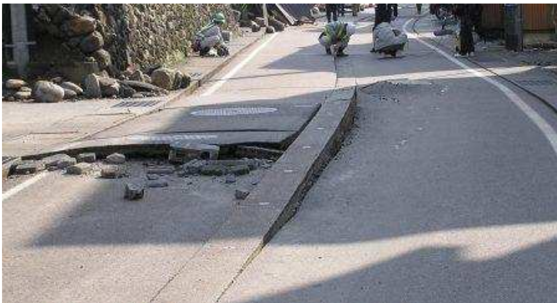
写真 1 路面の変状(川口地区)
