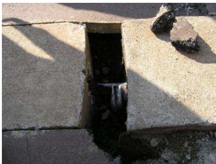
写真 3 消雪パイプの破断（和南津地区）
