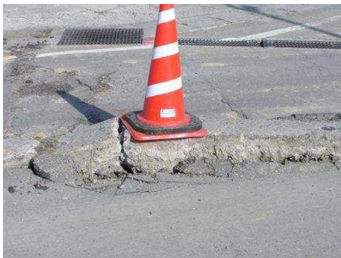
写真 2 消雪パイプの折れ曲がり（和南津地区）
