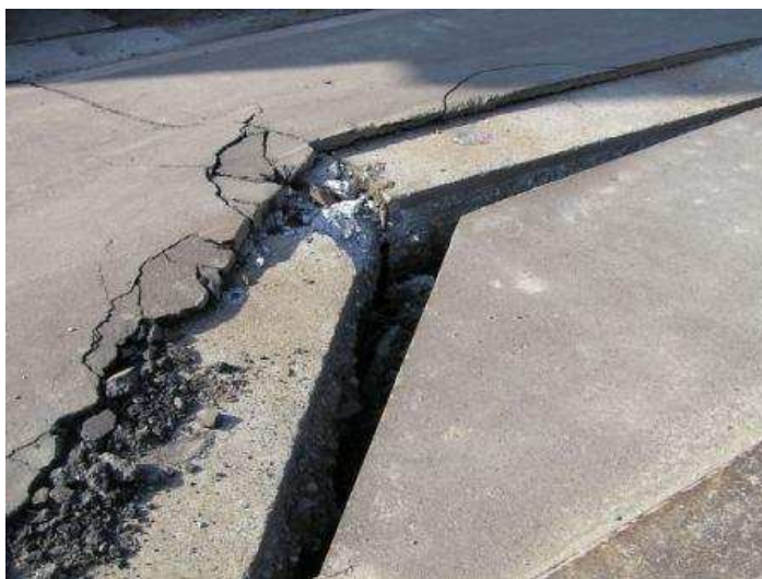
写真 4 消雪パイプとアスファルト路面との間に生じた亀裂と段差（和南津地区）
