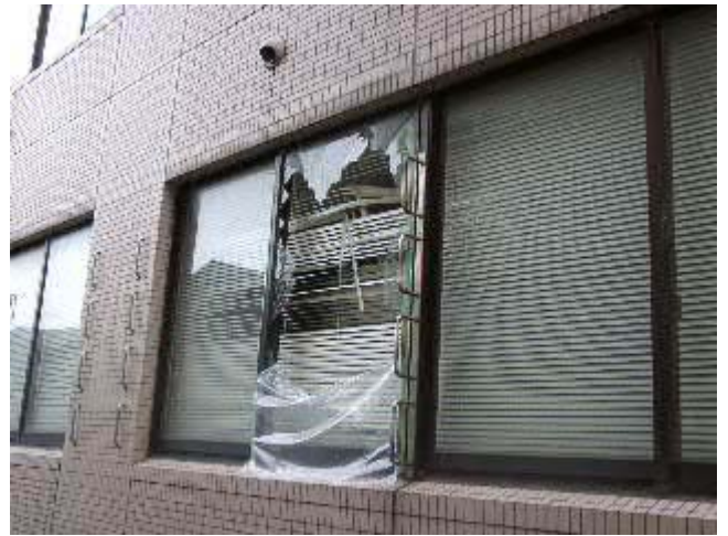
写真20 5号館の東側のガラスの割れ(多数有り)
