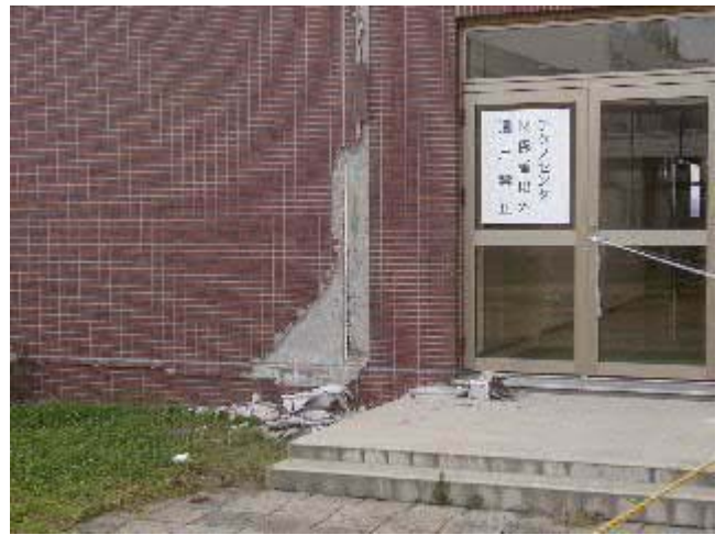
写真 1 5 よくみられたタイルの損傷 2
