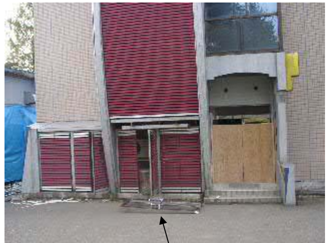
写真21 5号館の南のドアがはずれていた
