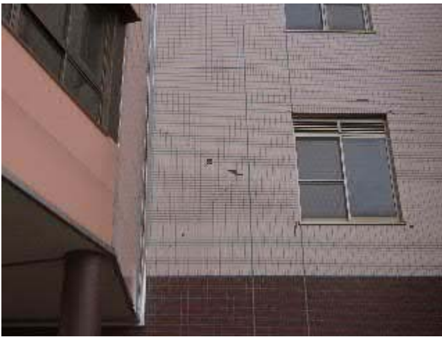
写真 1 2 1F 壁のせん断破壊
