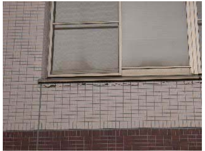
写真 1 4 よくみられたタイルの損傷 1
