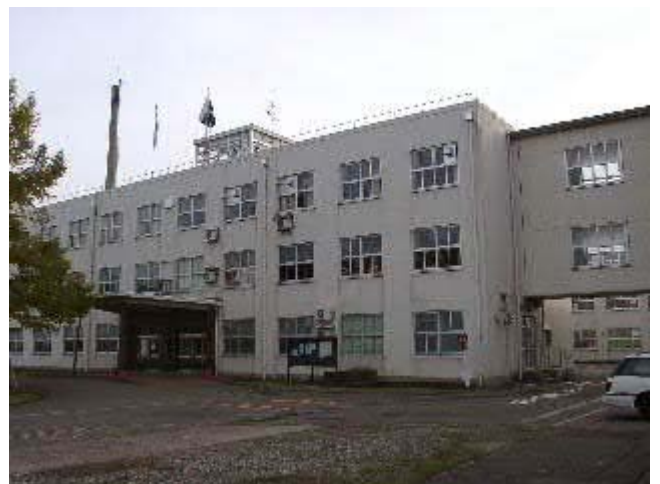
写真22 1号館(軽微なひび割れ有り)
