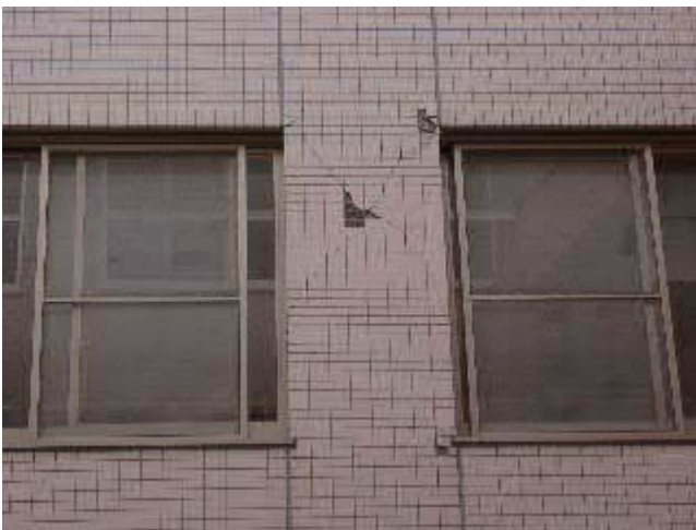
写真 1 3 2F 柱のせん断破壊
