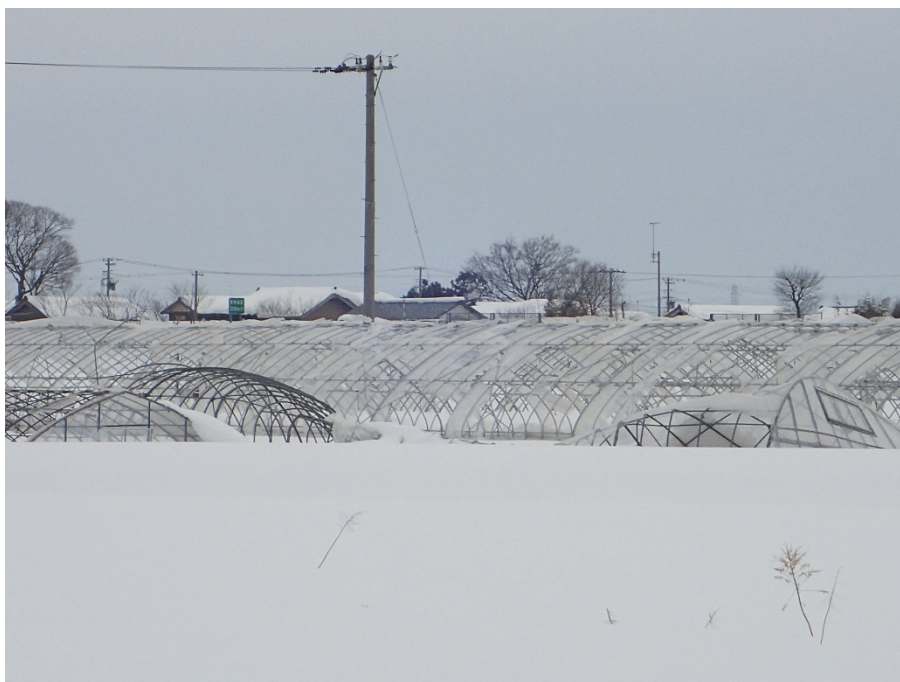
写真 4 農業用ハウスの屋根の陥没（坂井市丸岡町末政，図 1 の No.4）.
