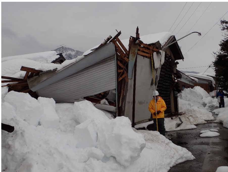
写真7 空き工場の倒壊（勝山市北郷町伊知地，図1のNo.7）
