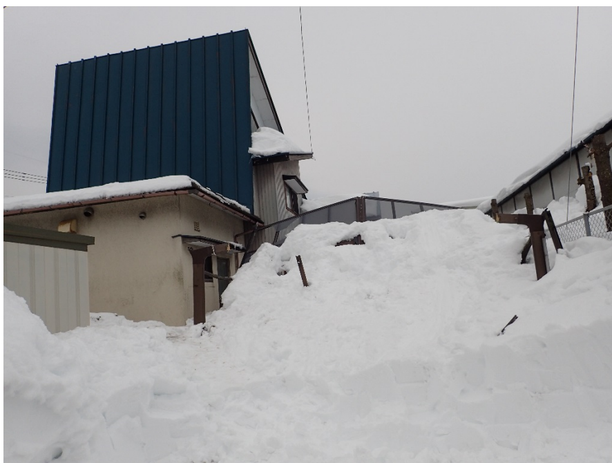
写真 3 カーポートの屋根の崩落（坂井市丸岡町牛ヶ島，図 1 の No.3）.
