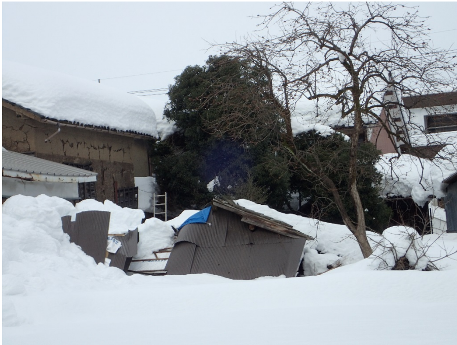
写真5 織物工場の倒壊（永平寺町松岡春日，図1のNo.5）。
