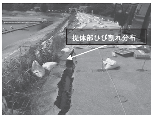
図1 被災農業用ダム堤体部の損傷状況
