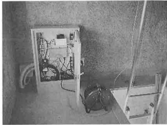
図3 山古志支所棟屋内の通信装置
