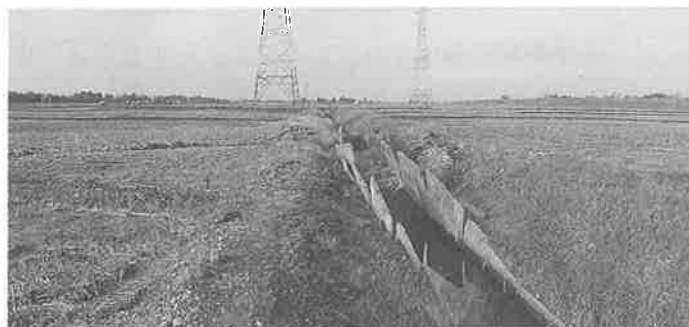
中越地震により破壊された農業用水路
